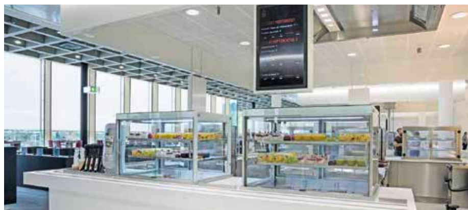
CO 2 : Die zentrale Kälteanlage der Mensa am Campus Garching arbeitet vollends mit dem natürlichen Kältemittel Kohlendioxid.
